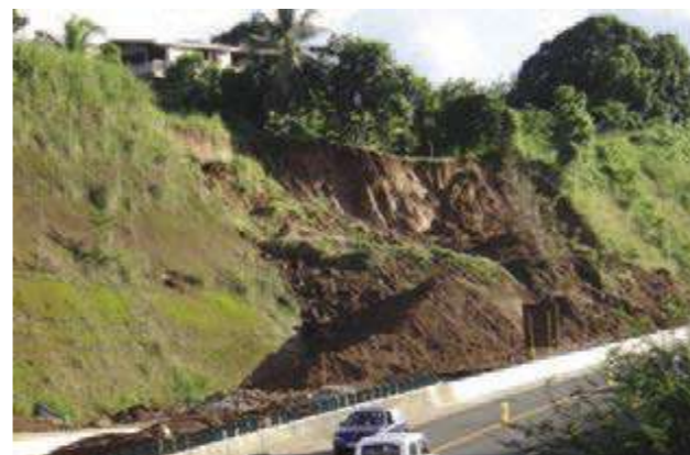
Effondrement d'un talus au droit de la RN1 (Morne-Bourg) - Fp Atlas des Paysages de l'archipel Guadeloupe
