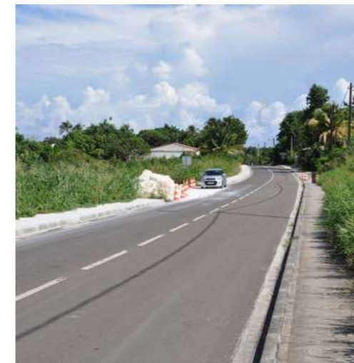
L'usage de certains matériaux de remblais peut devenir problématique pour les milieux (Lessivage des fines) - Travaux de remblais du bas-côté- Fp SIGNES
