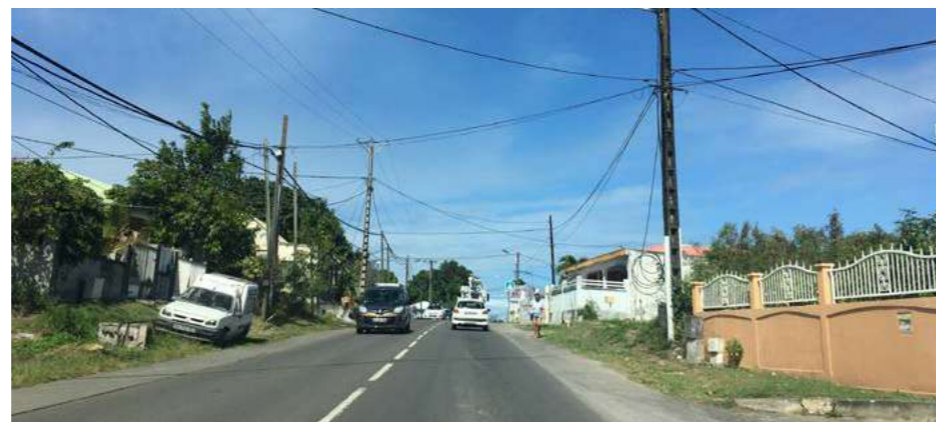
Sur une grande partie de la séquence, la voirie présente des bas-côtés bétonnés utilisés comme cheminement piéton. Sans mesures de sécurité (bordure, potelets...) ces cheminements ne permettent pas aux usagers de circuler en toute sécurité.
